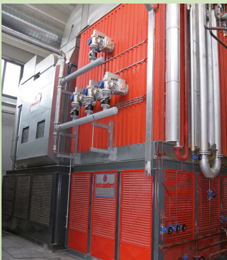
A sinistra, il sistema di estrazione ceneri; a destra, lo scambiatore di calore
