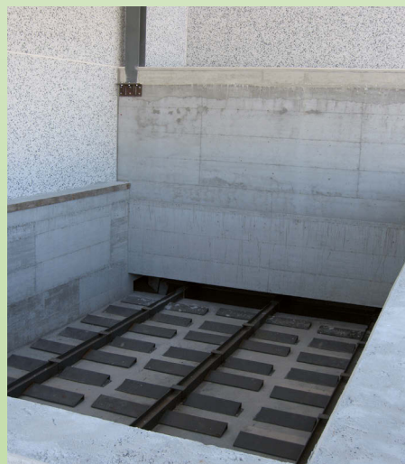
Silo di stoccaggio del cippato, sistema walking floor
