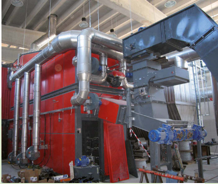
Sotto, l'impianto con la camera di combustione in primo piano
